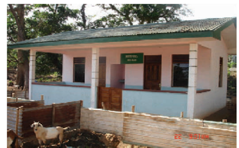
Postu SCSA iha Bauro Sub-Distritu Lospalos ne'ebé hetan Manutensaun di'ak husi Komunitade, iha Lutu haleu atu evita balada sira labele tama
